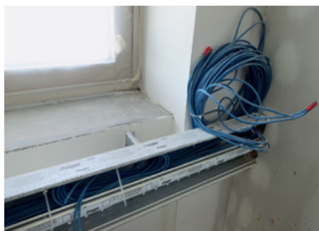
18. 5. 2020 Žlaby pro elektroinstalaci
