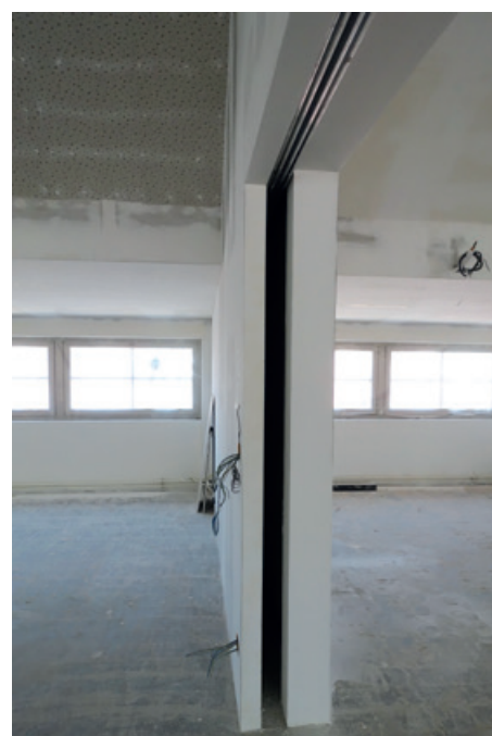
18. 5. 2020 Pouzdro na zasunovací dveře
